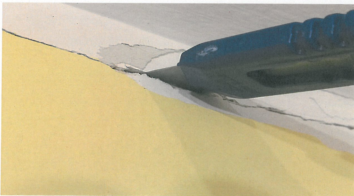
Fot 5. Ilustruje głębokość rozwarstwienia poziomego rysy w strefie pod sufitej
